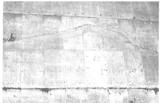
図1 コールドジョイントの事例
