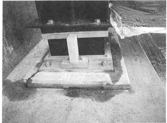
写真-1 沓モルタルのひび割れ状況
