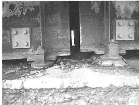
写真一 1 支承の台座コンクリートの破損
