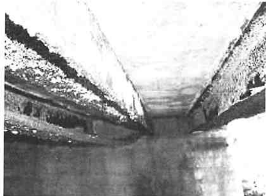
写真一 二 損傷が発見された橋
