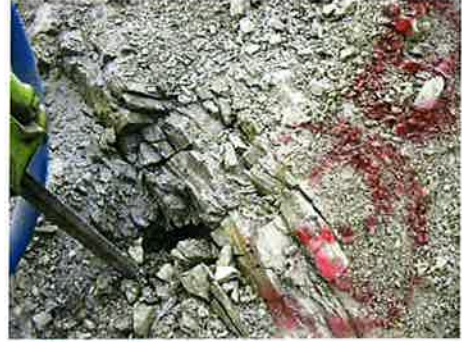
写真-2 表面部崩壊
