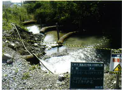
写真-2 ろ過設備 (ヤシノミ繊維のフィルター)
