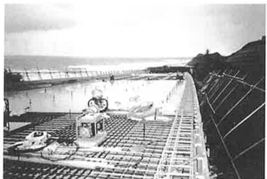
写真-1 雪寒仮囲災害状況
