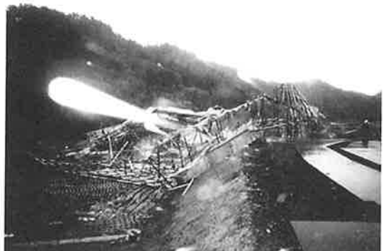
写真-2 雪寒仮囲散乱状況
